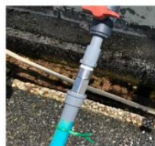
水産総合研究センター様への設置
